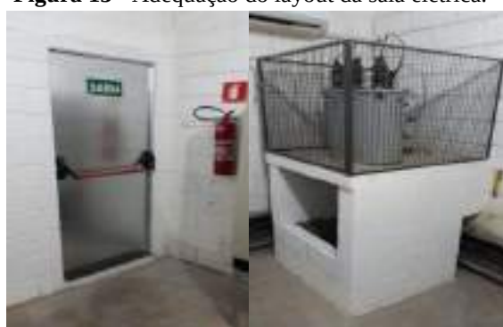
Figura 13 - Adequação do layout da sala elétrica.
