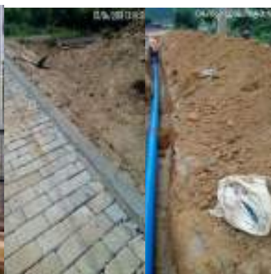
Figura 58 - Adutora (ligando os poços a nova EAB).
