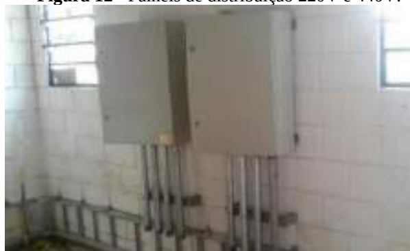
Figura 12 - Painéis de distribuição 220V e 440V.
