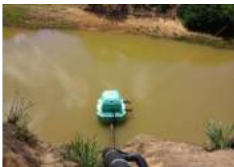
Figura 16 - Flutuante com duas bombas (1 reserva).
