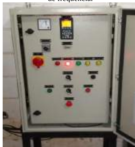
Figura 15 - Painel de acionamento com inversor de frequência.
