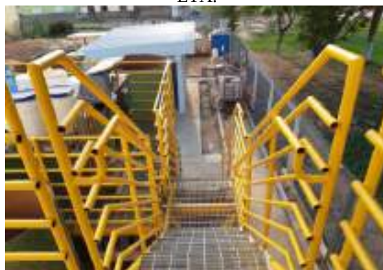
Figura 56 - Passarelas de segurança e operação da ETA.
