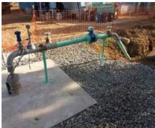
Figura 14 - Poço fornecido pela Fundação Renova.
