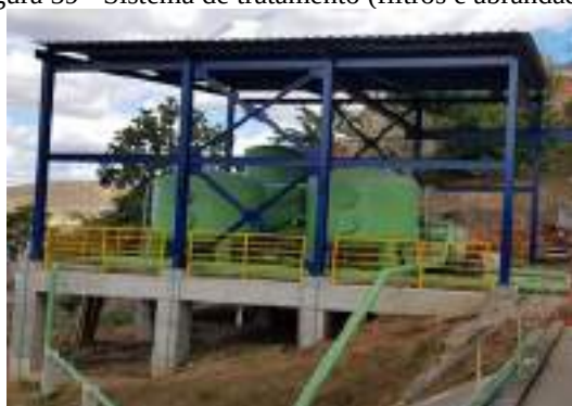
Figura 59 - Sistema de tratamento (filtros e abrandador).
